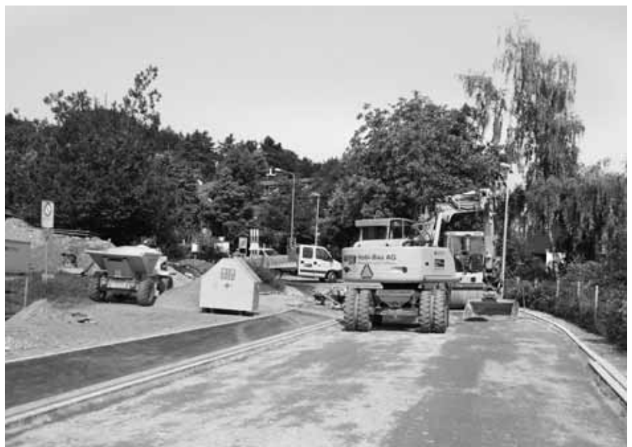
Die Baustelle Im Bränneli, Forch, verärgert viele Anwohner. Die einen rufen bei der Maurmer Post an und beklagen sich, andere schreiben ans Bauamt. (Foto: sl)
